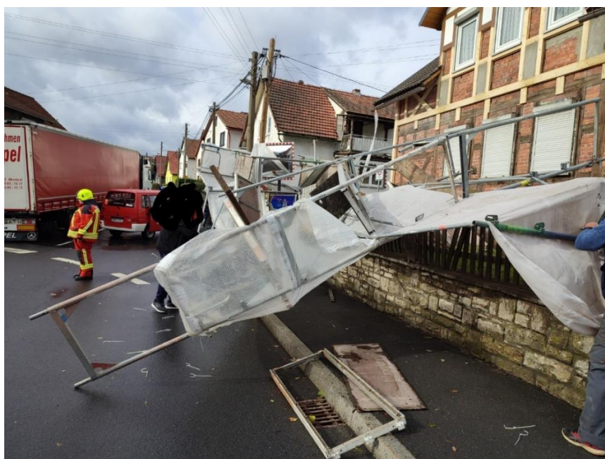
Großes Glück hatten Fußgänger und Autofahrer am 21.10.2021, als ein Sturm ein ungesichertes Baugerüst umweht.
